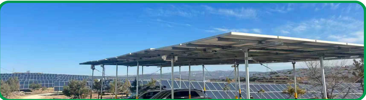
张家口万全光伏电站太阳能发电车棚
