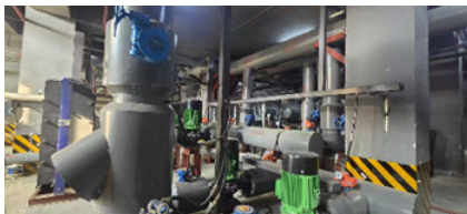
燃气锅炉余热回收改造
